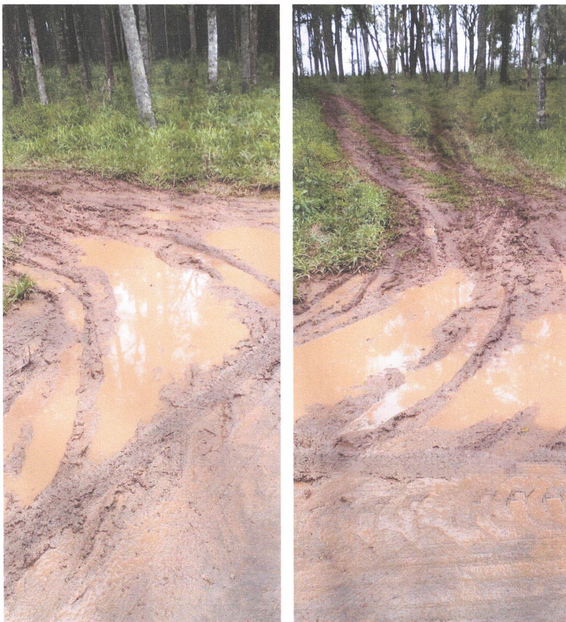
Foto – Solicitação de implantação de bueiro na comunidade Anta Ruiva.
